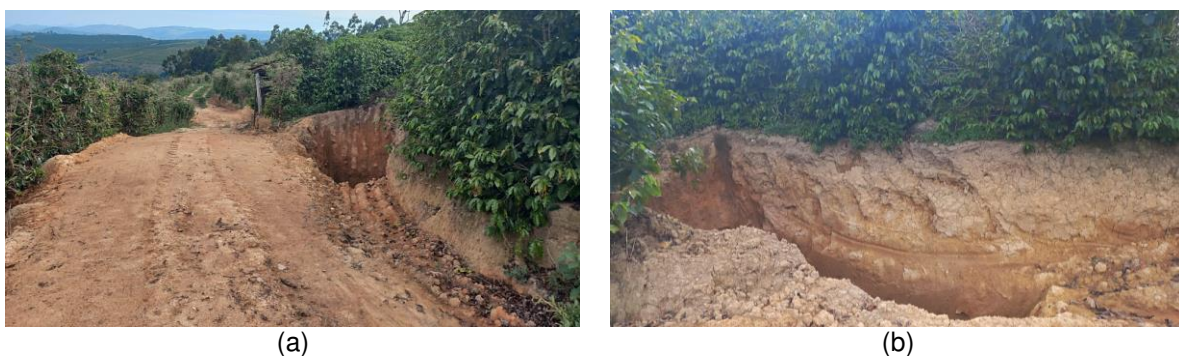
Figura 11 – Técnica de gestão de águas de estradas vicinais conhecida por “caixa seca”, em área de cafezal (a), e detalhe de instalação aproveitando as entrelinhas de café (b).
